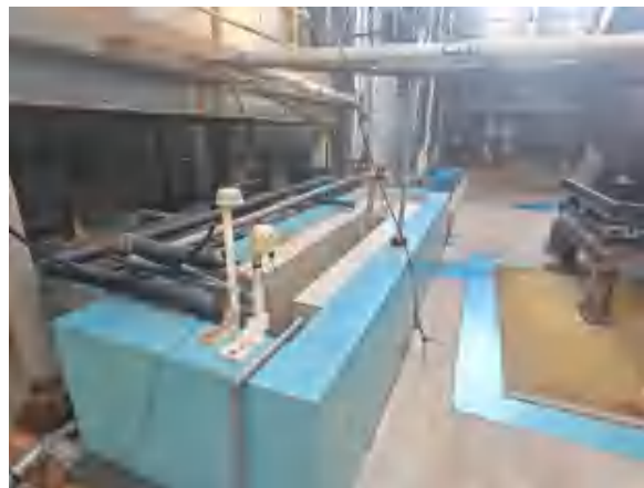
高盐废水排放口
