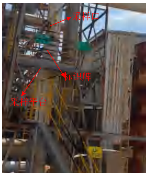
依托现有 DA001 排气筒及废气处理设施
