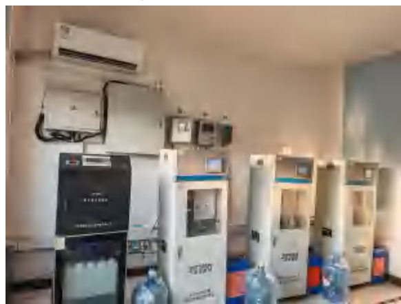
综合废水在线监测（DW001）
