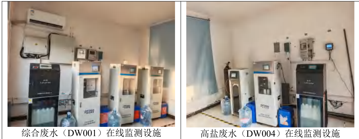
图 4-9 废水在线监测设施
