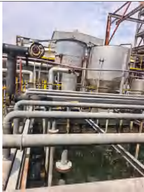
厂区污水处理站
