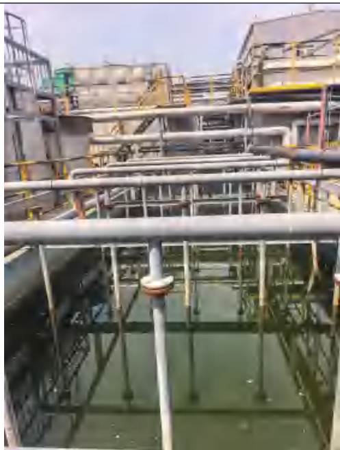
厂区污水处理站
