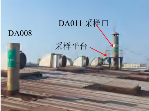
依托现有 DA011 及 DA008 排气筒及采样平台
