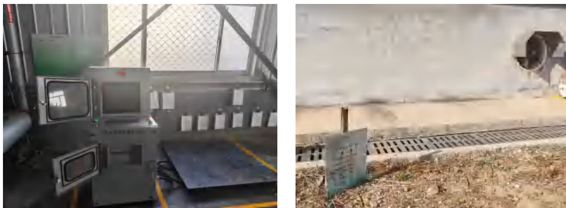
图 4-5 公司危废暂存间
