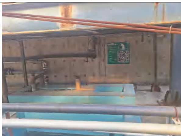
DW001 废水排放口
