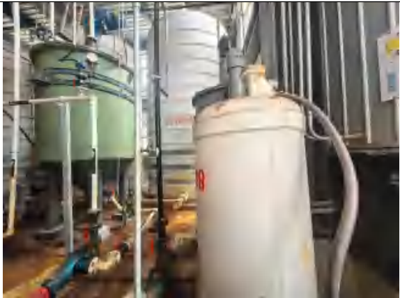
铅钡车间 3#废水处理设施
