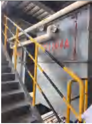
铅一车间 1#无机废水处理设施
