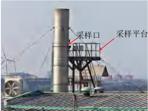
依托现有 DA013 排气筒及采样平台
