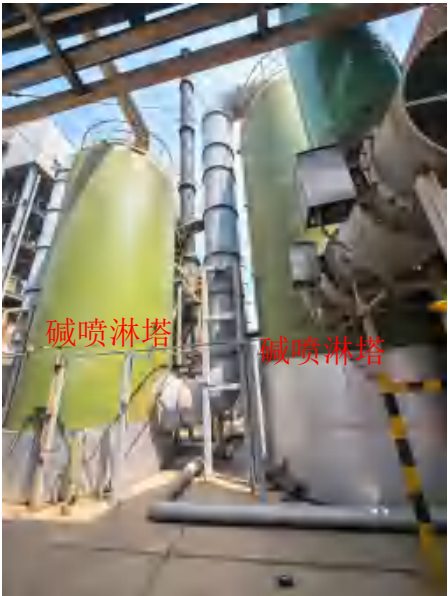
依托现有 DA001 的两级碱喷淋塔
