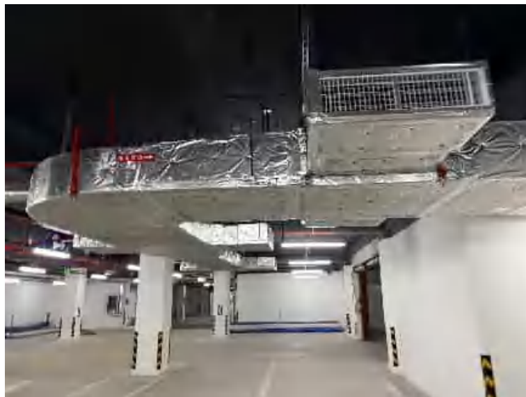
图 4-3 排烟排风管道及风口
