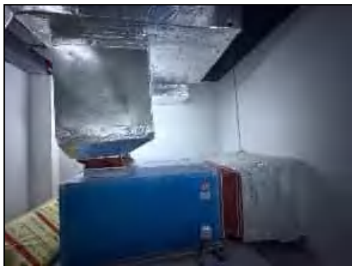
图 4-30 设备柔性连接及减震设施
