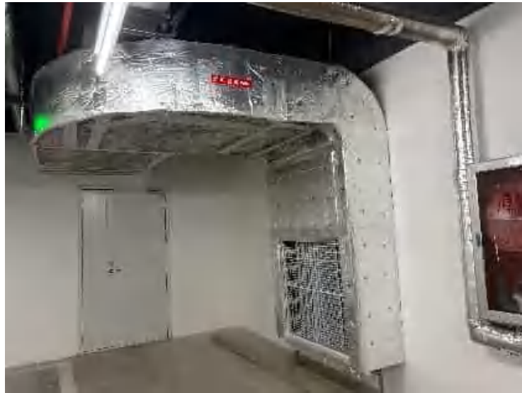
图 4-2 送风管道及风口
