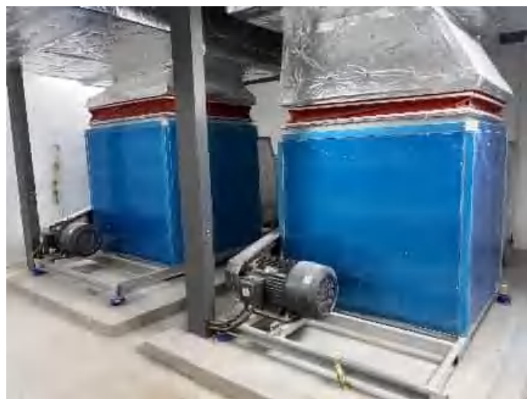
图 4-4 风机房及风机设备
