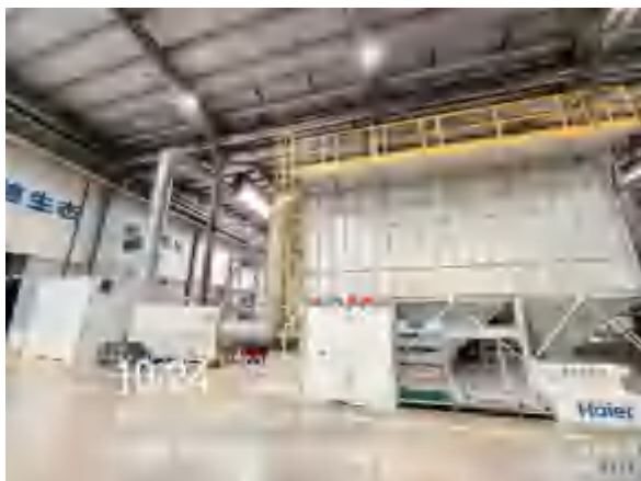
液晶综合拆解线废气处理设施 (布袋除尘器+载硫活性炭)
