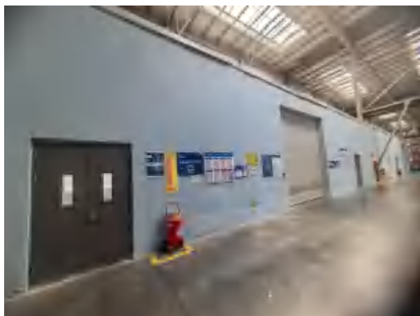
1#危险废物暂存间外景
