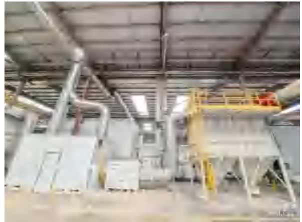
CRT 综合拆解线废气处理设施 (布袋除尘器+活性炭吸附)
