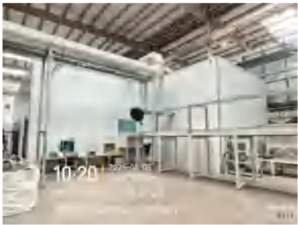
CRT 综合拆解线封闭负压操作间
