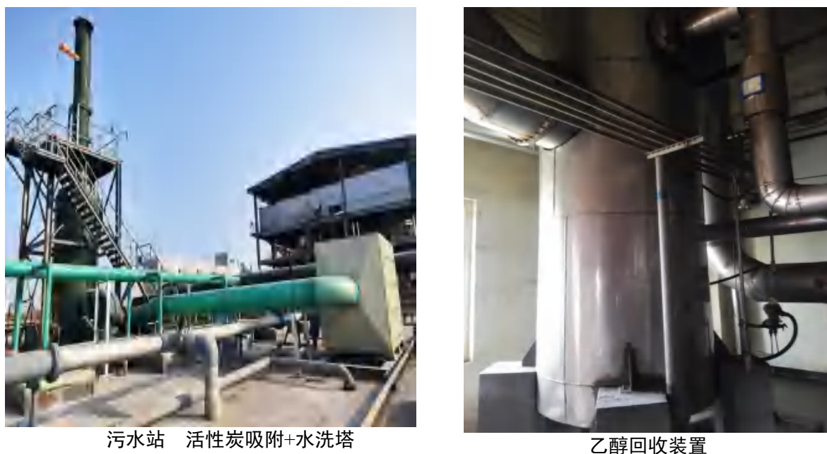
图 4-2 废气处理设施及排气筒
