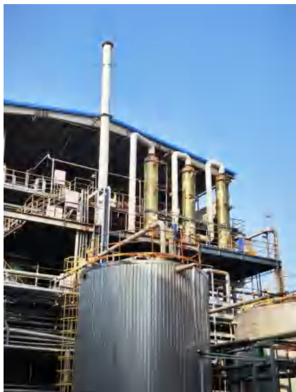
二期芬顿 三级碱喷淋塔
