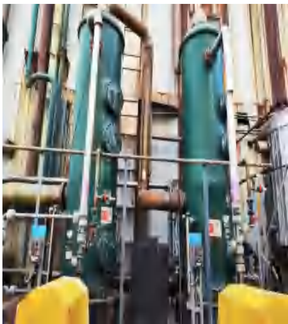
907 车间 两级碱喷淋塔
