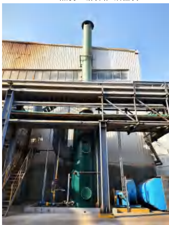
闪蒸干燥车间 喷淋塔
