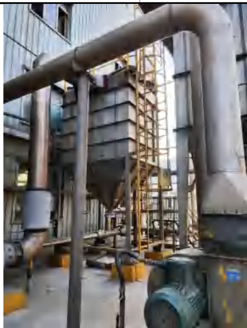
901 车间 布袋除尘器
