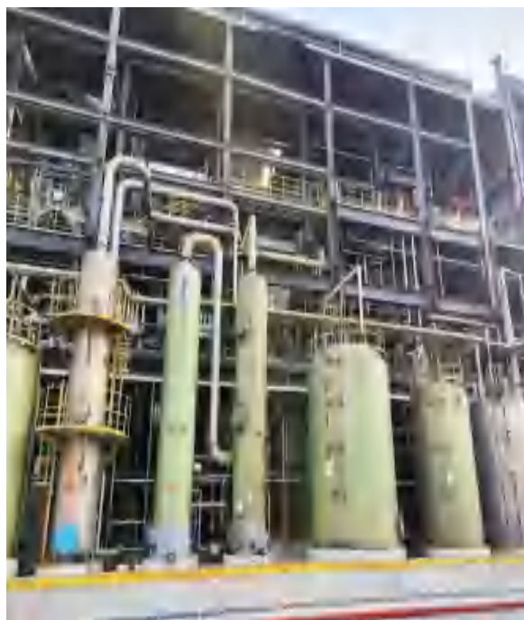
909 废酸裂解炉前的碱喷淋（左侧一个）、二级碱喷淋+活性炭
