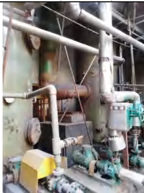
902 车间 二级碱喷淋塔
